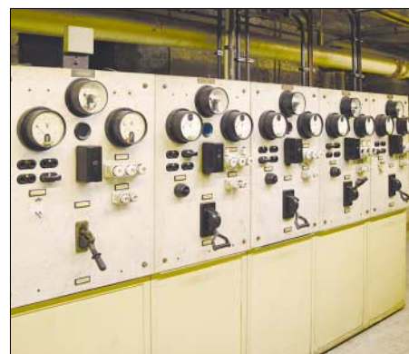
Bild 10: Noch erhaltene Rohrpost-Schalttafeln im Keller des ehemaligen Haupttelegrafnamts in der Oranienburger Straße Foto: Stefan Lehmann
