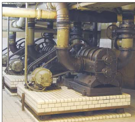
Bild 8: Gebläseapparate der Hausrohrpost im ehemaligen Haupttelegrafnamt Foto: Stefan Lehmann
