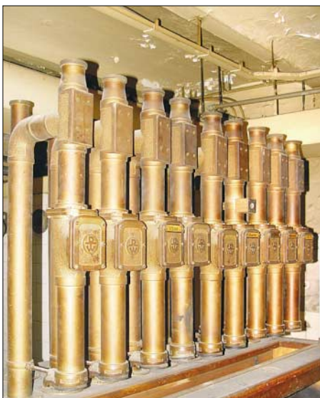
Bild 5: Hausrohrpostanlage (Empfangsstation) des Haupttelegrafenamtes
